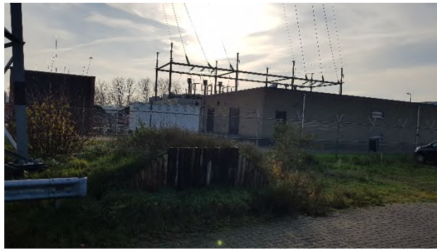
Foto 1.14 | 110 kV Station (DVTB110) Londenstraat 1T
