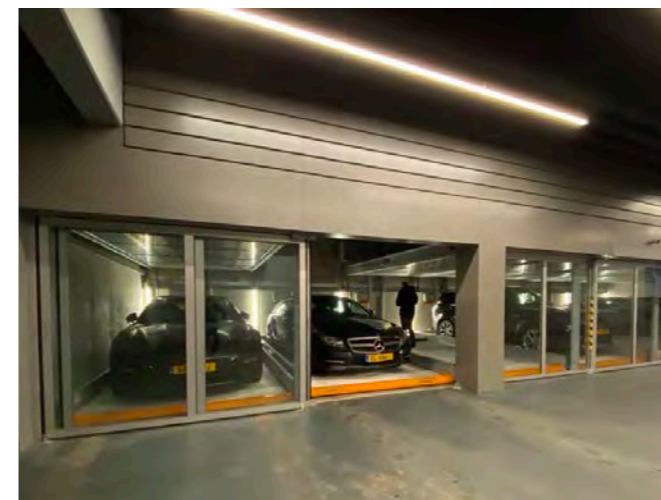
Drielaags semi-automatisch parkeersysteem
