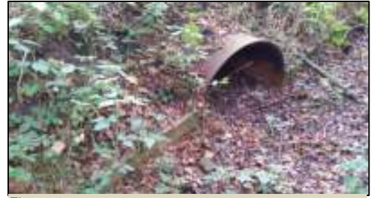
Figuur 4. Achterstallig onderhoud bij de amfibieënpijp waardoor de geleiding geen effect meer heeft. Bron: Matthé Wind
