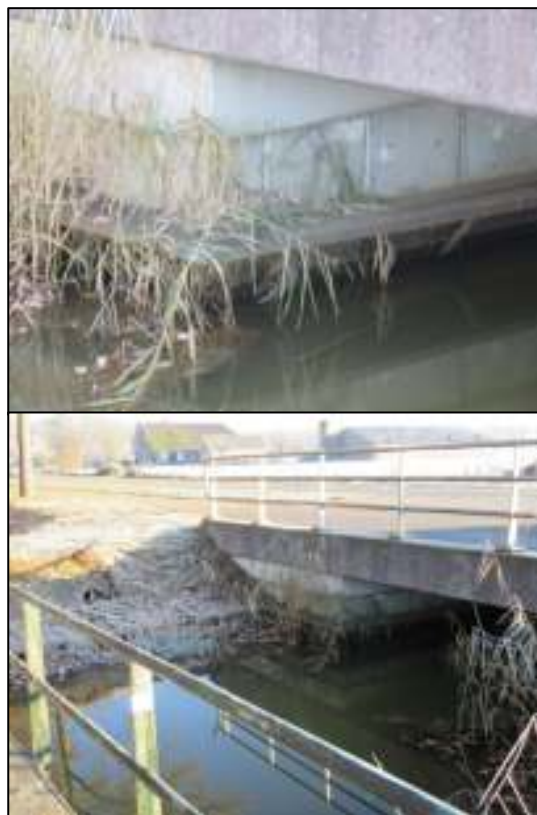
Figuur 45. De faunapassage zonder geleiding langs de Soestwetering onder de Raalterweg. Bron: Matthé Wind
