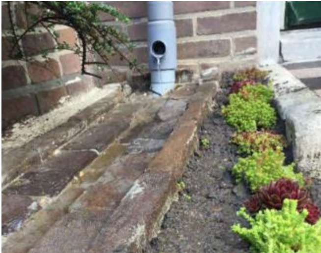
De Worp - Deventer Op een effectieve manier water op slaan en te laten infiltreren in de bodem.
