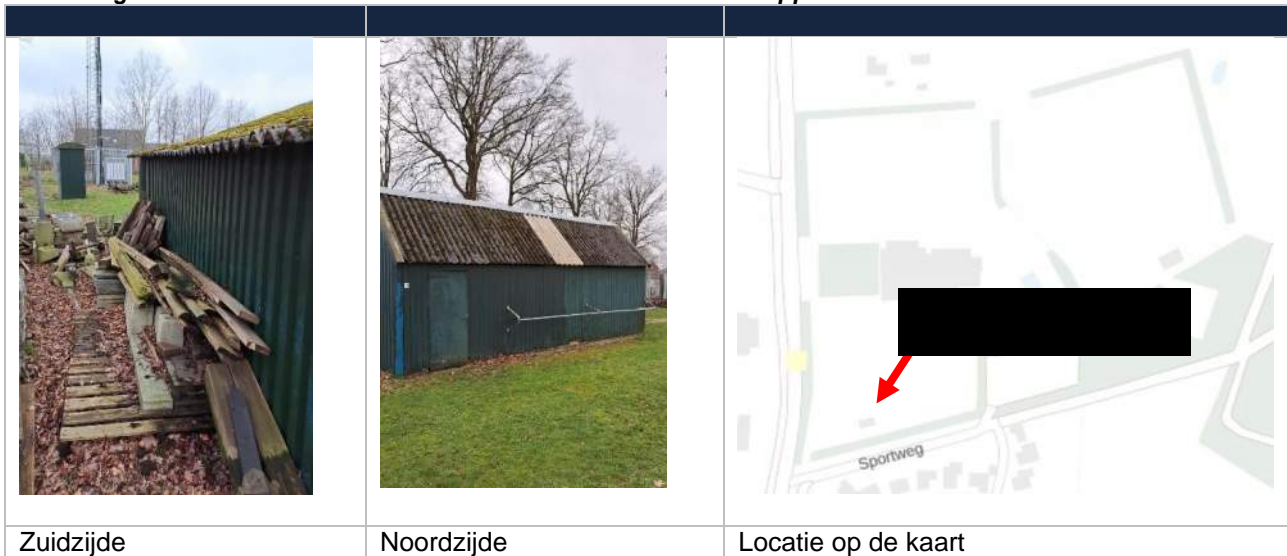
Afbeelding: Foto's en locatie schuur met asbestverdacht dak en druppelzones
