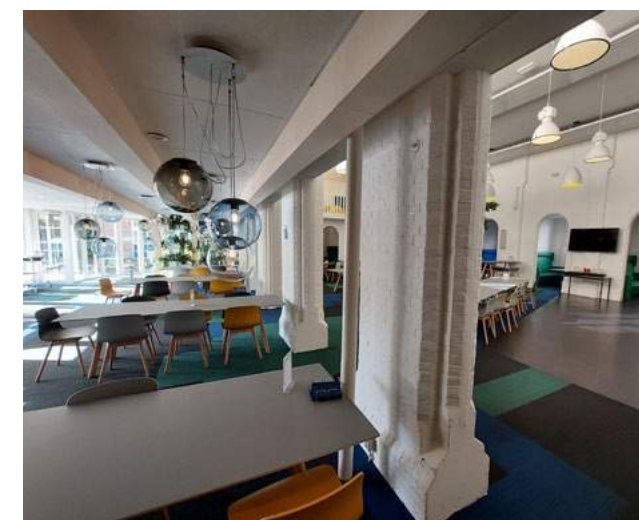
De linkerkzijde is de aanbouw voor de gevel van de Gymzaal aan het binnenterrein. De ramen zijn hier weggehaald.
