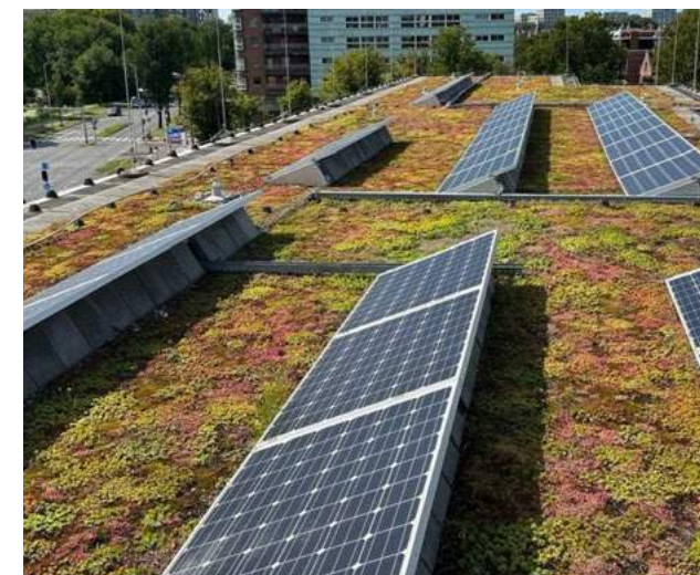
Zonnepanelen op de hoogste daken
