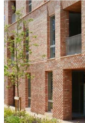
Plastiek in gevel door terugliggend metselwerk
