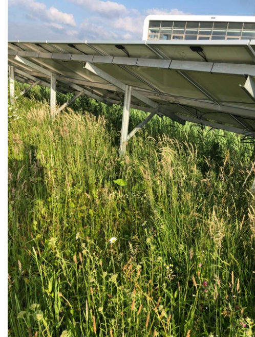
referentie zonnepanelen bij GLW reclamemast Assen
